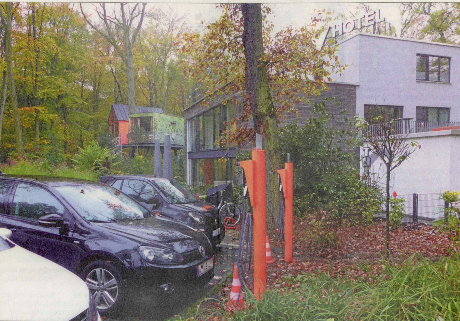
Parkplätze direkt vor der Tür hat das V-Hotel, zwei davon sind mit E-Ladestationen bestückt, die in knalligem Rot gestrichen sind. FOTO: ROLF KLEINFELD
